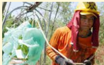
Mise en place du « cable vía », un système pour transporter les régimes de bananes des champs à la station d'emballage. Grâce à ce système, le quotidien des travailleurs s'est nettement amélioré : avant ils devaient porter les lourds régimes sur de longues distances, aujourd'hui ils ont juste besoin de les tirer le long du fil.
